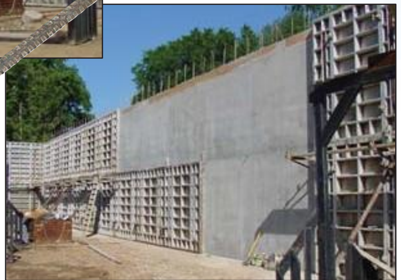
Des grands panneaux à double hauteur sont utilisés pour un projet commercial.
