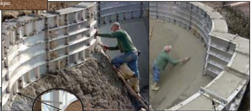
Processus de finition du sol de la piscine en transition avec les murs Support de Garde-Corps (voir page #39)
